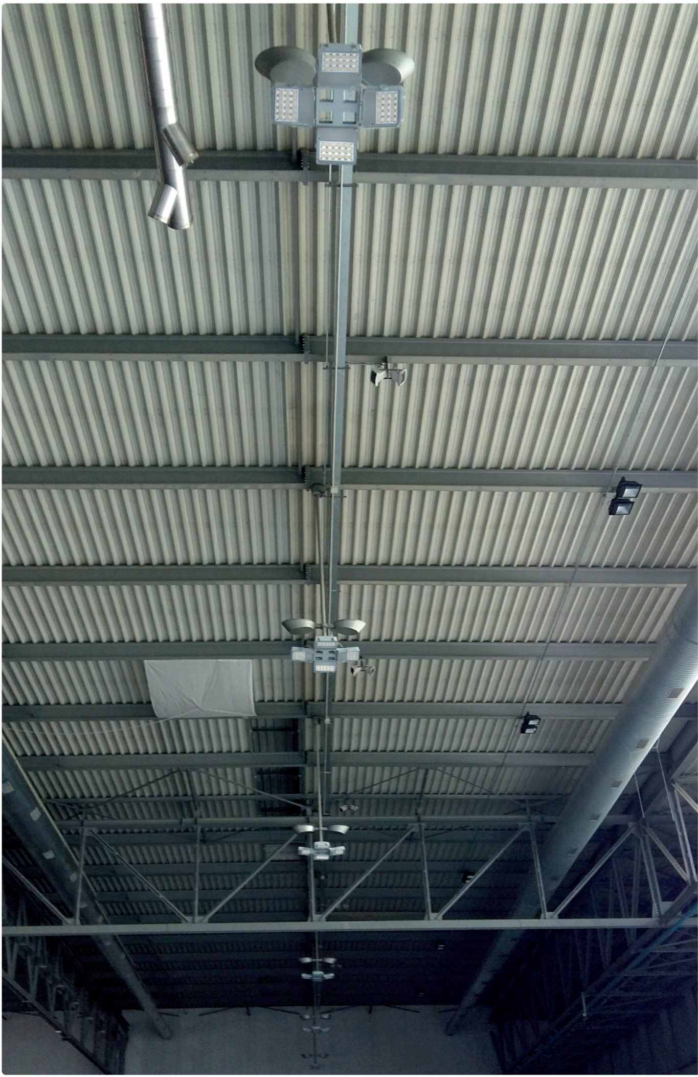
131 proiettori da esterno / outdoor floodlights
