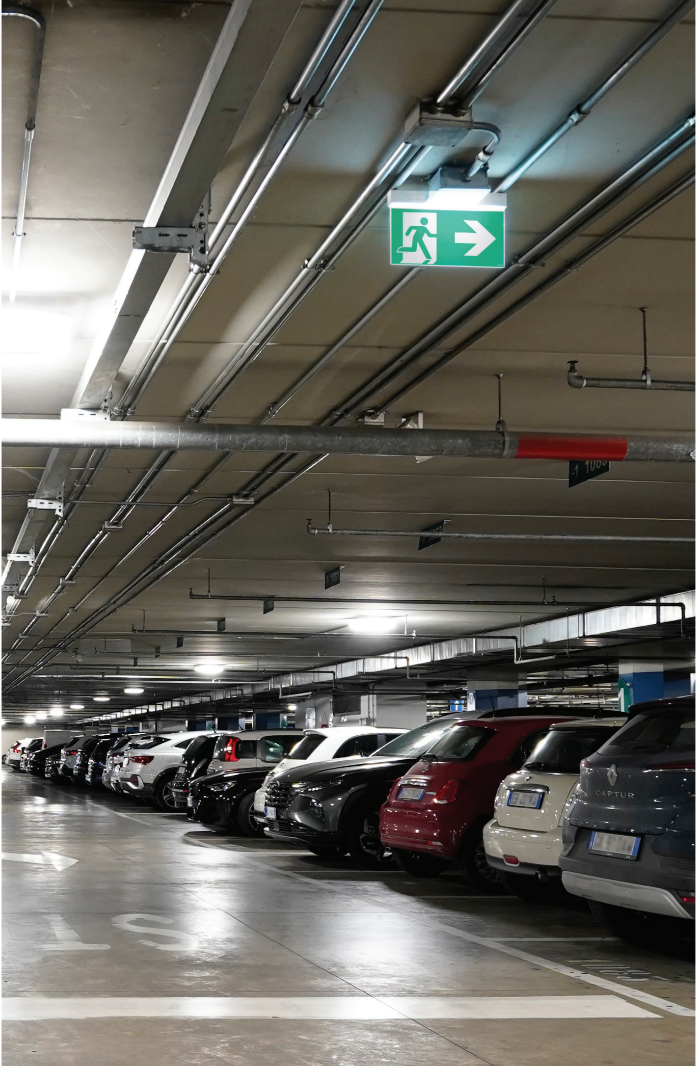
141 segnaletica / exit sign
