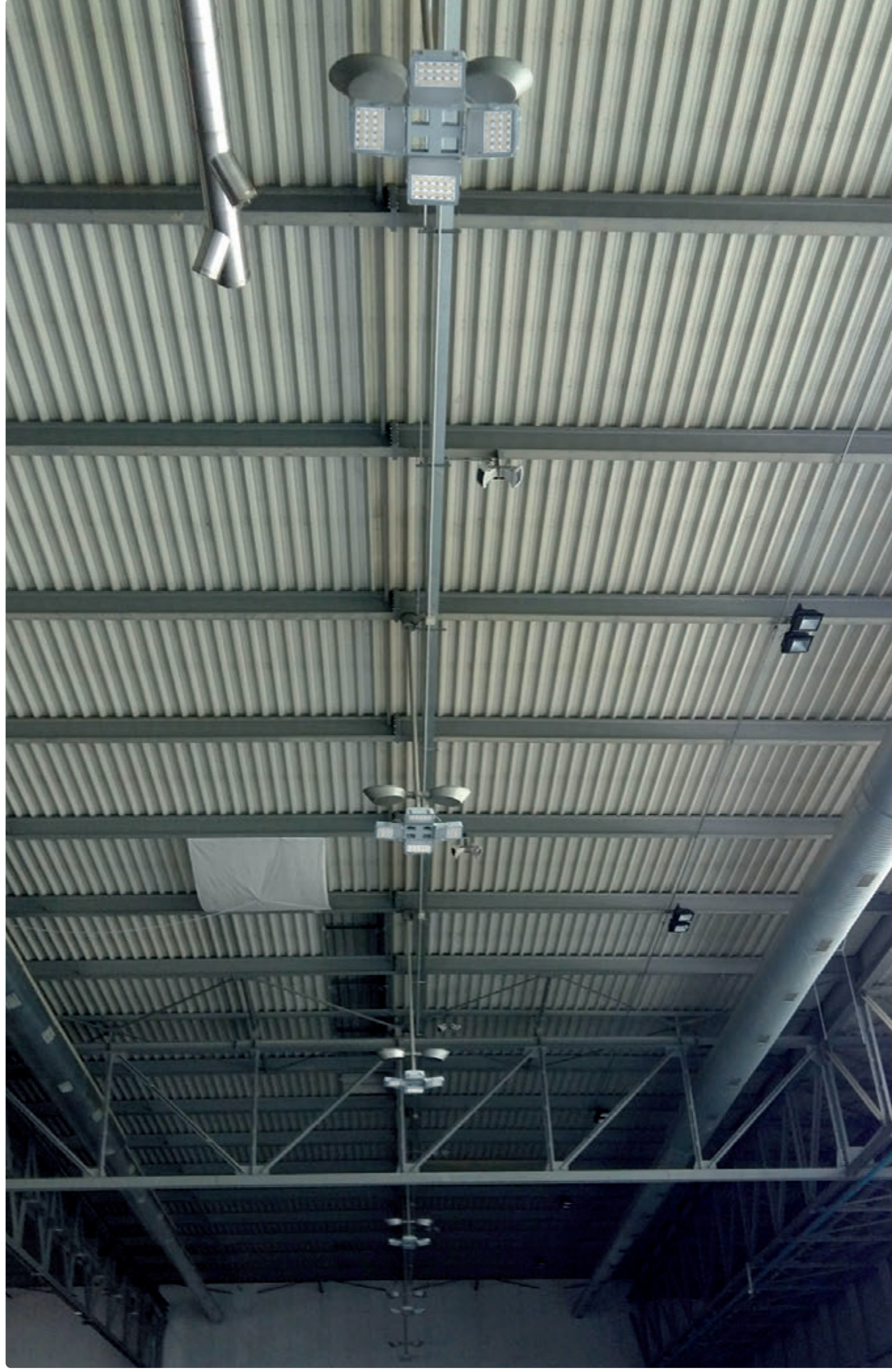
131 proiettori da esterno / outdoor floodlights
