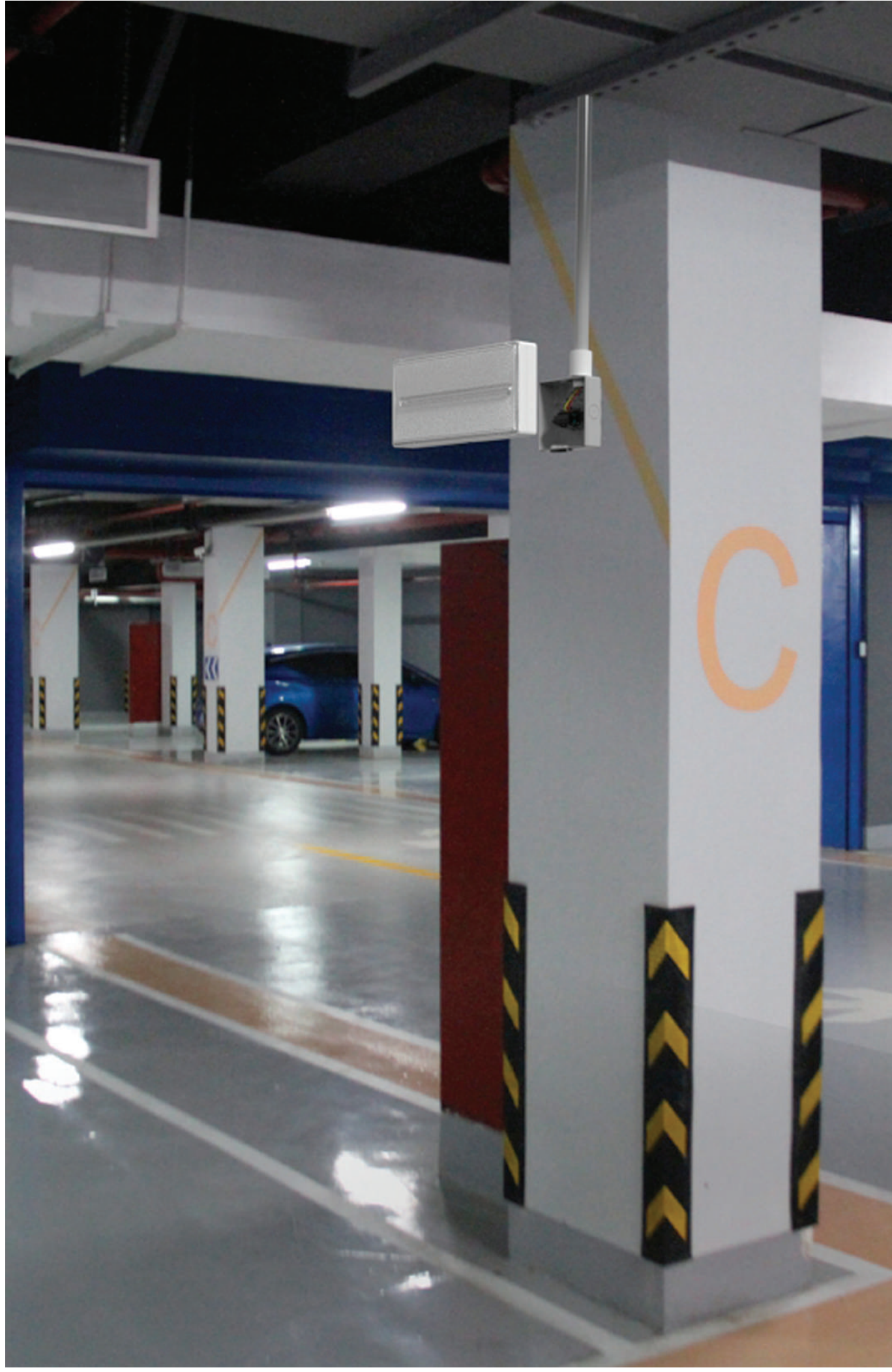
035 oprawy oświetlenia awaryjnego
