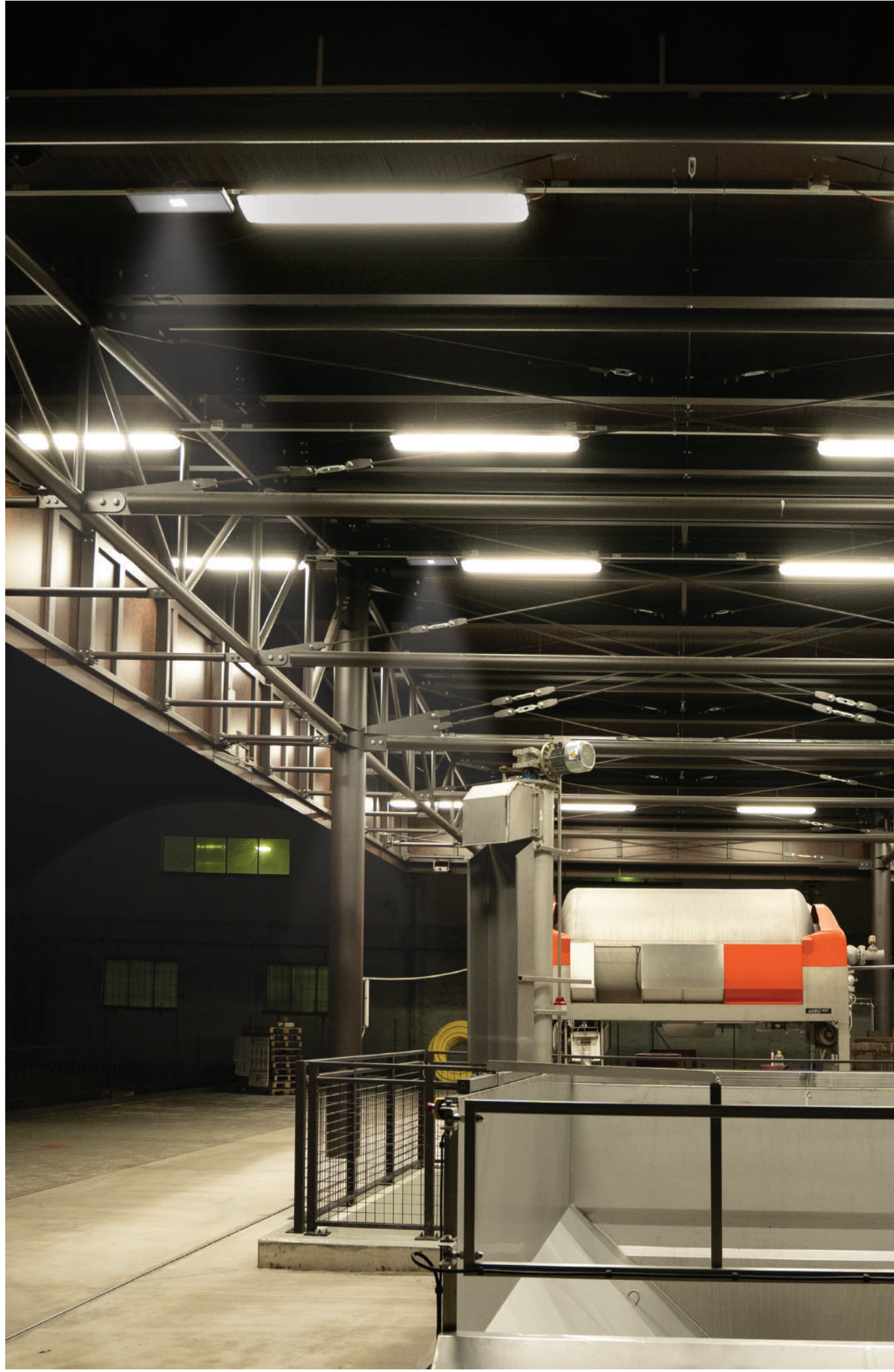
047 oprawy oświetlenia awaryjnego
