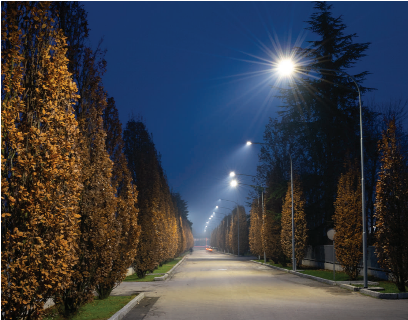
159 oprawy uliczne / street lighting
