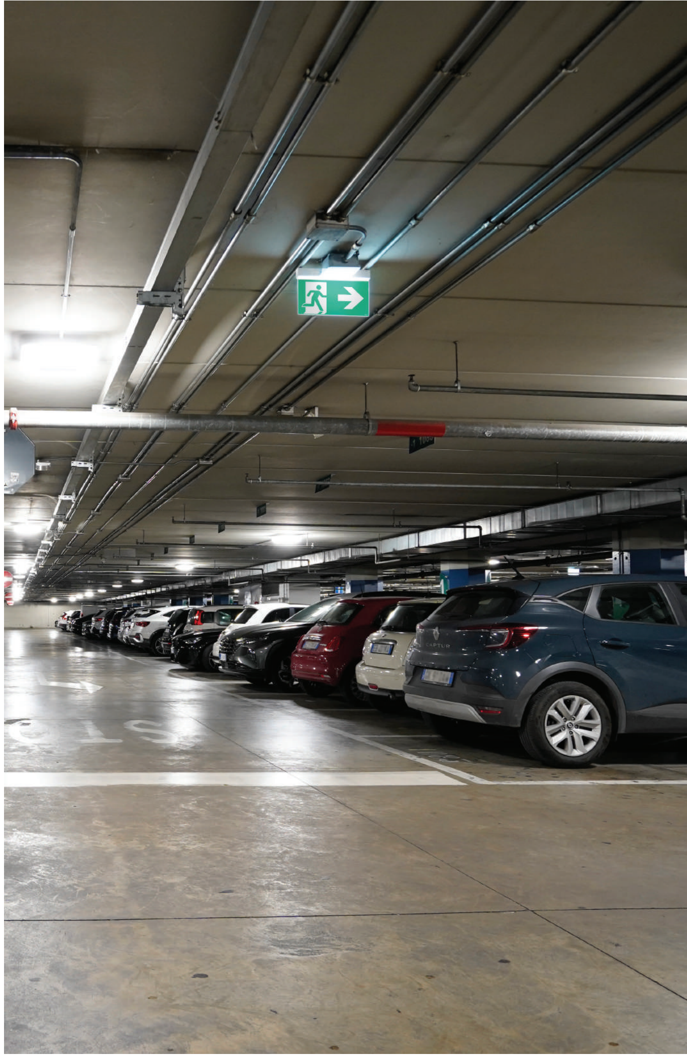
073 oprawy kierunkowe / exit sign
