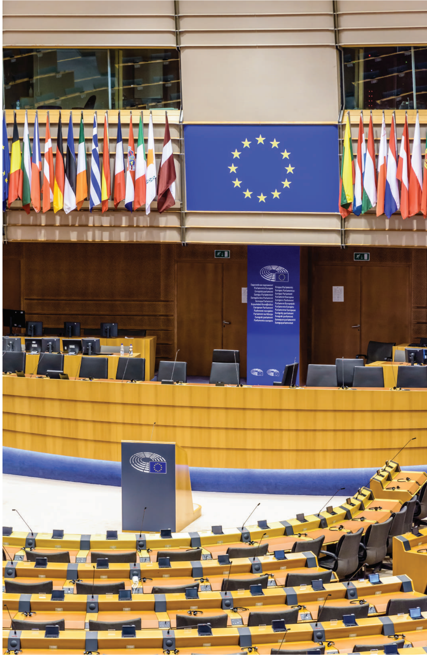
025 oprawy oświetlenia awaryjnego / emergency luminaires
