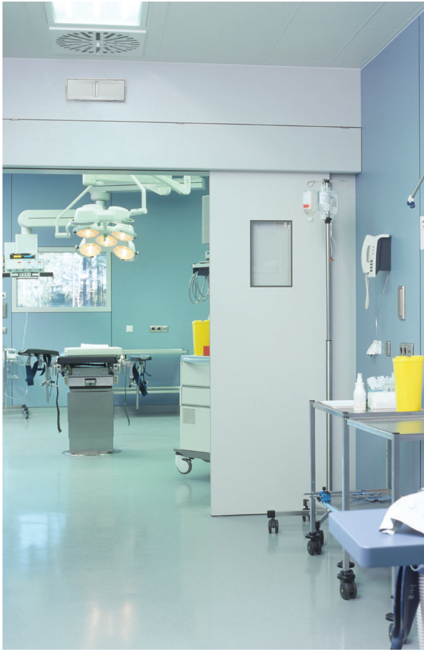
037 oprawy oświetlenia awaryjnego / emergency luminaires
