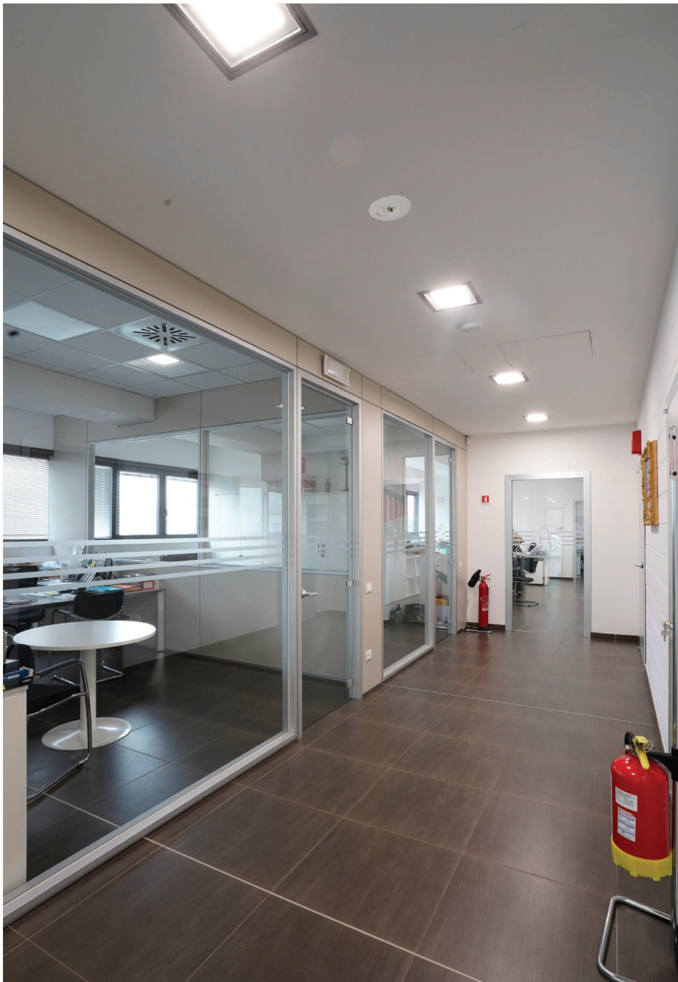
053 kompaktowe oświetlenie awaryjne / spotlights
