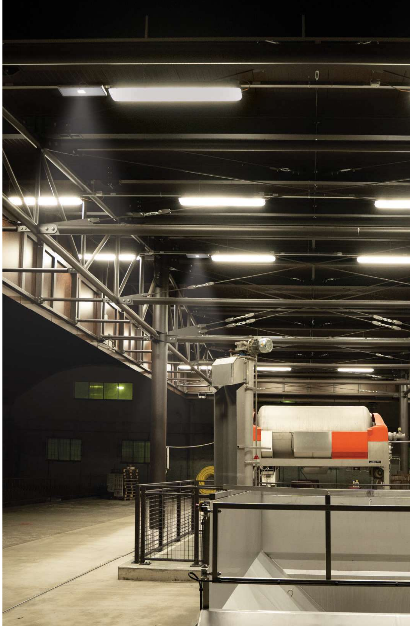
047 oprawy oświetlenia awaryjnego
