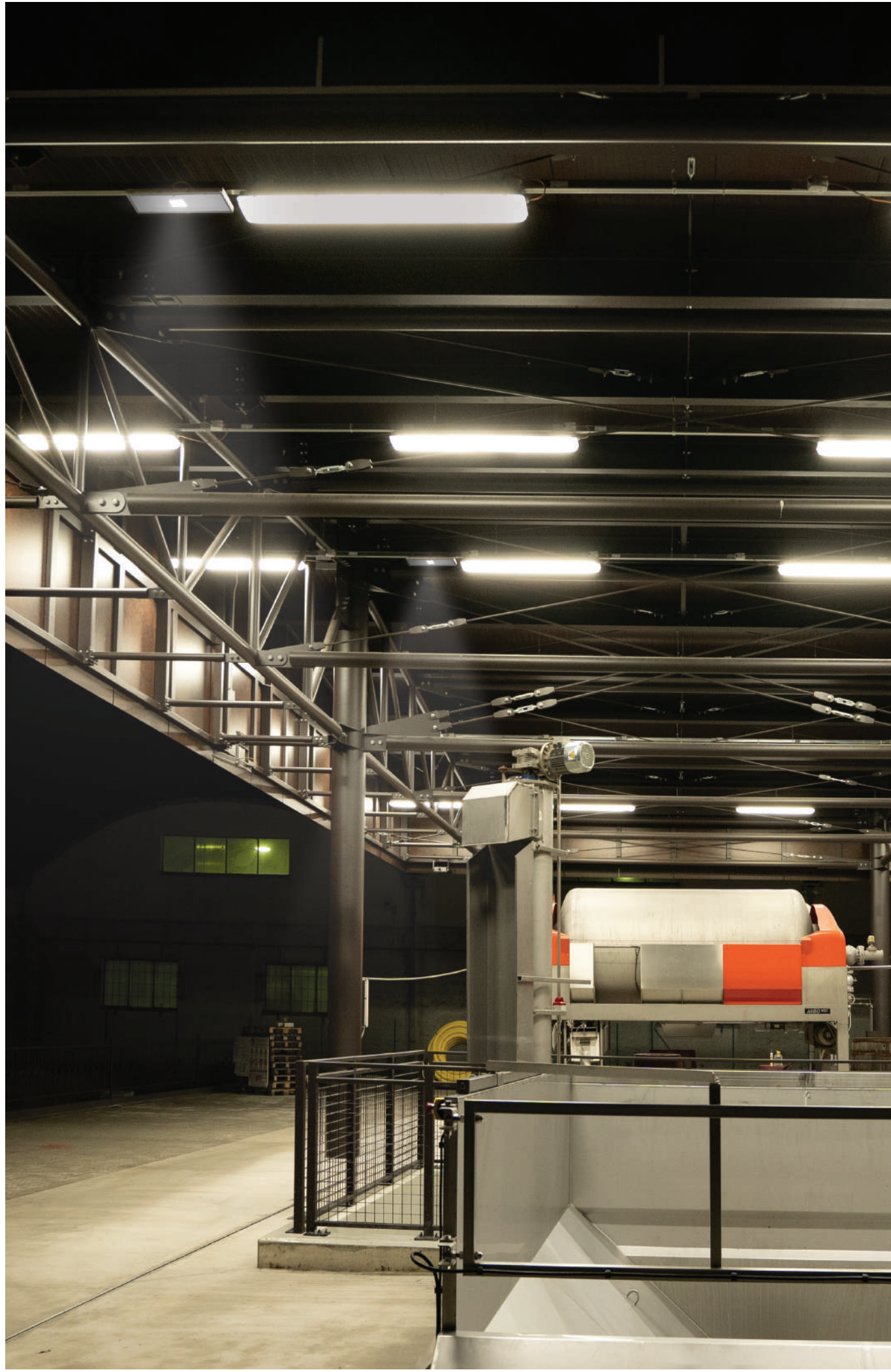
oprawy oświetlenia awaryjnego / luminaires
