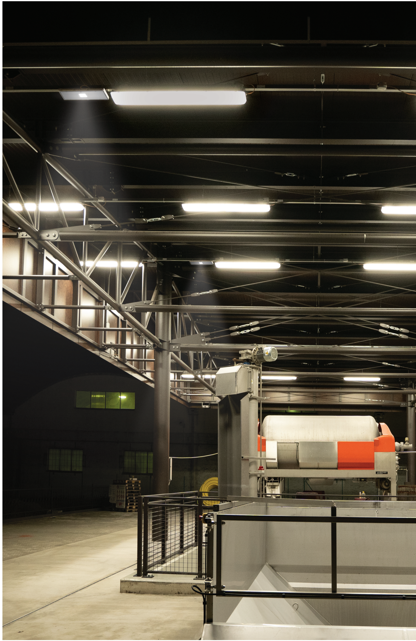
oprawy oświetlenia awaryjnego / luminaires
