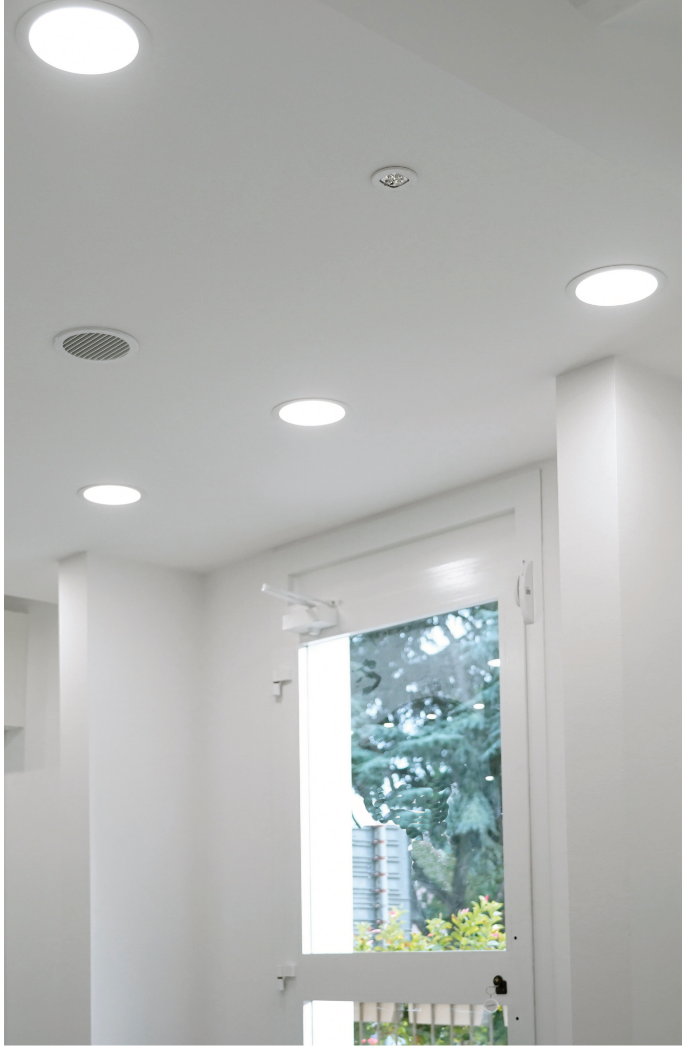
architektoniczne oświetlenie awaryjne / architectural luminaires
