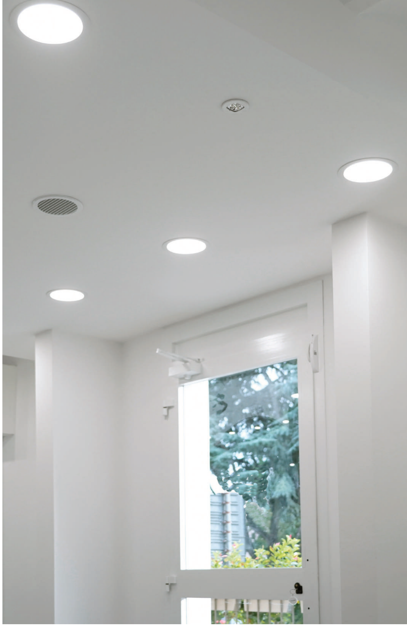
architektoniczne oświetlenie awaryjne / architectural luminaires
