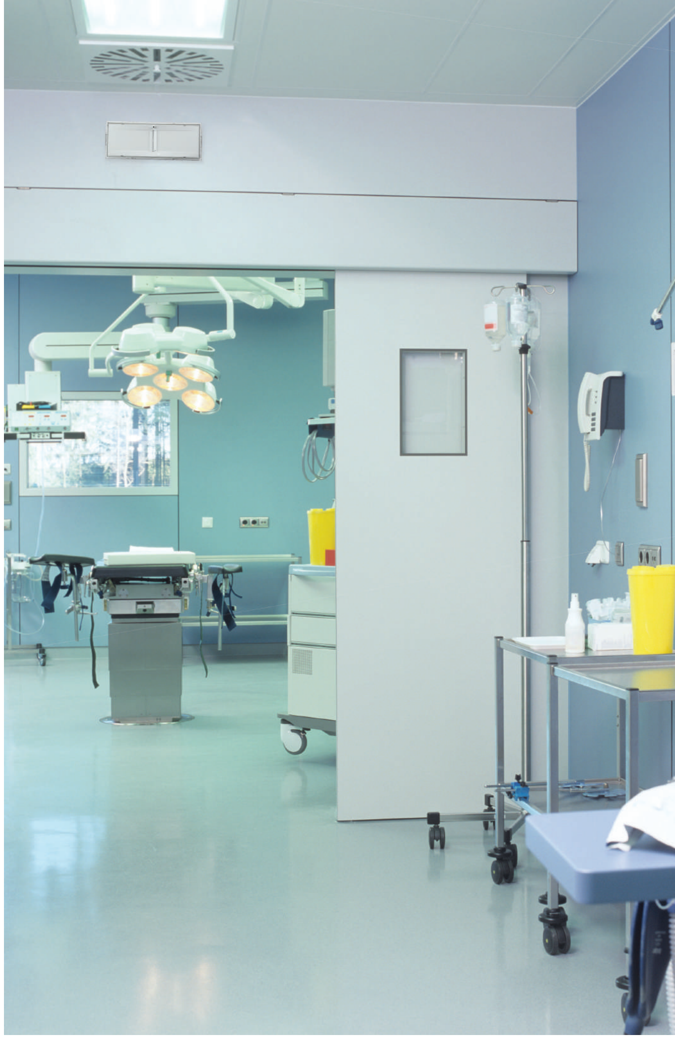
oprawy oświetlenia awaryjnego / luminaires
